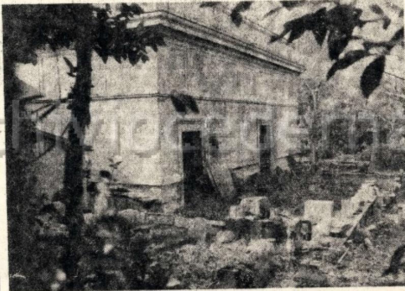
L'Antiquarium comunale, nel parco del Celio: sono visibili i segni dell'abbandono
