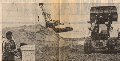
Lavori sul litorale per il ripascimento e nell'altra foto un'immagine dell'Appia Antica
